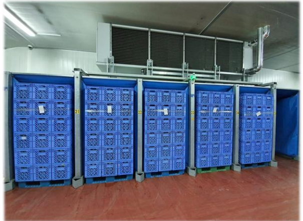
Soğuk hava deposu
